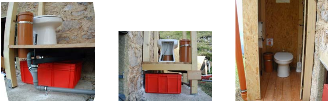
Bild 2 –4: Details der Toilette mit Lager und Transportbehälter, Papierschacht sowie Vorrichtung zum Abhalten der Reinigungswässer.
